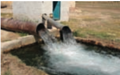
Pompaj kuyuları (P1, P2)
